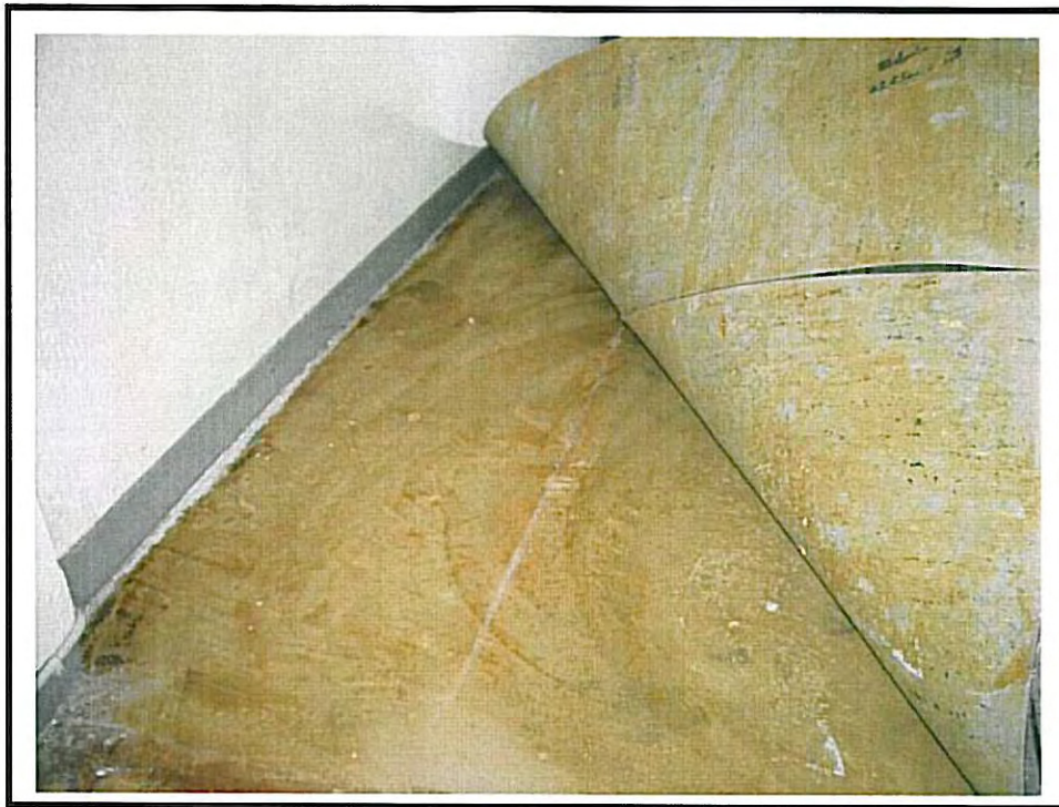
Bild 14: dünner Kleberbelag am PCV-Boden auf Estrich/Betonboden
